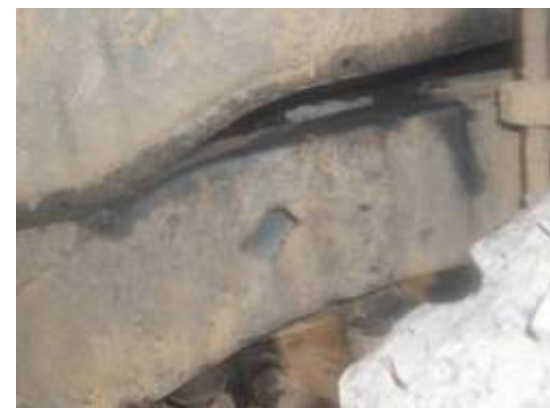
Дефект сварного шва
