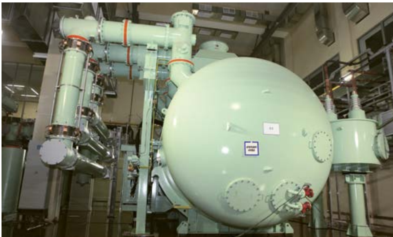
Элегазовый трансформатор 220/20 кВ на подземной подстанции Сколково. Фото предоставлено ФСК
